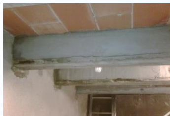
Presencia de humedad
