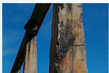
Carbonatación, corrosión por cloruros
